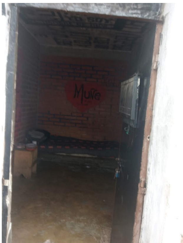
Celda de castigo pabellón de mujeres centro penitenciario de "San Roque" ciudad de Sucre, no existen ventanas, solo una ranura en la puerta.
