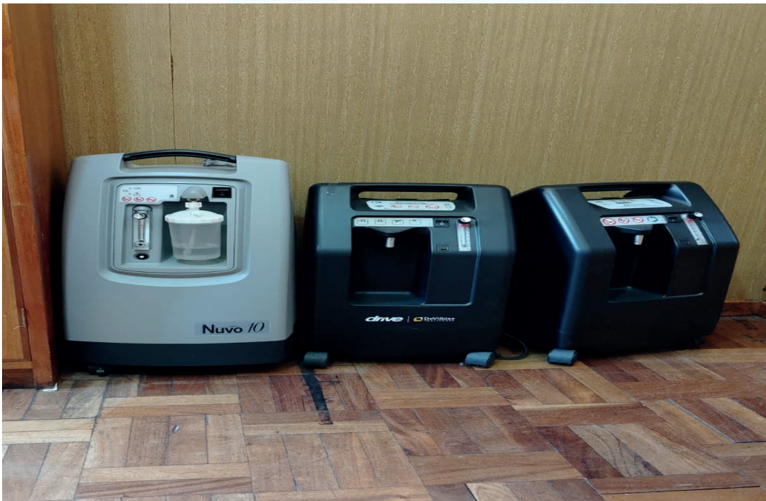
Generadores de oxígeno sin funcionamiento
